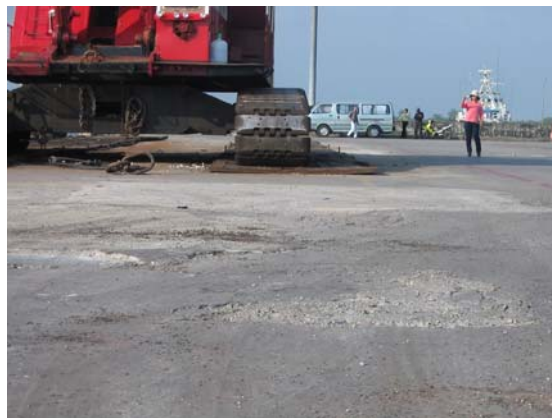
ท่าเทียบเรือที่ชำรุดเนื่องจากไม่สามารถรับน้ำหนักอุปกรณ์ยกขนตู้สินค้า
